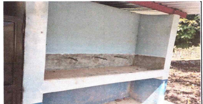
Foto 6: Captacion de agua para baños de establecimiento
