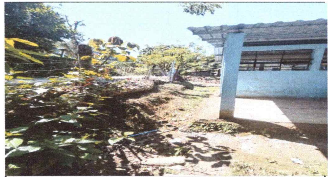
Foto 4: Perfil de levantamiento de muro perimetral 92 ML
